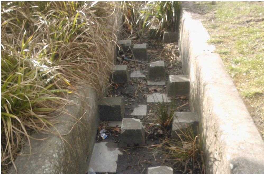
Figur 37. Betongränna för ledande av dagvatten i Augustenborg, Malmö
