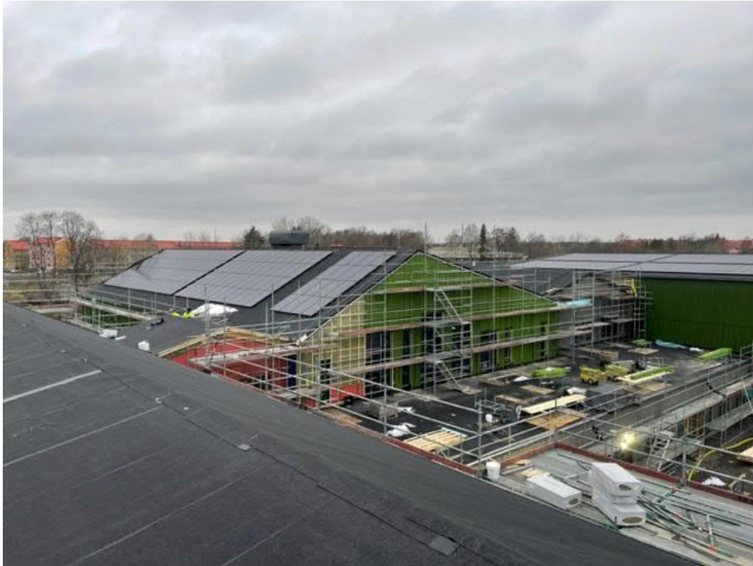
Takvy över Hus 1,2 och 3 med monterade solpaneler.
