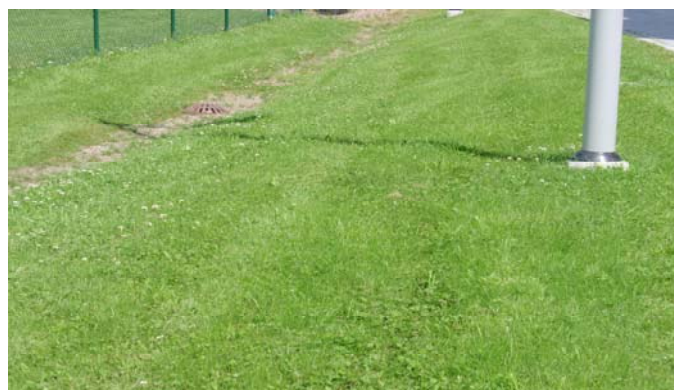
Dagvatten avleds till ett grund dike ifrån vilket infiltration sker till nedgrävda utjämningsmagasin.
